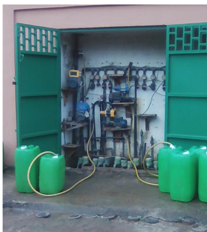
Photo 2 : Vue de supresseurs installés pour un immeuble à Abobo-Dokui (Cliché, Kouamé H., 2016)
