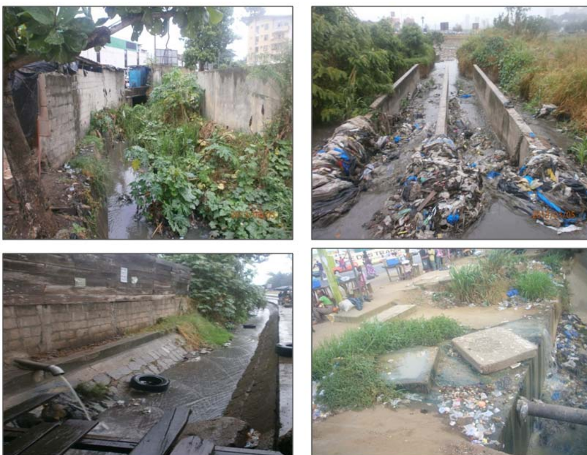
Figure 12 : Aperçu des canalisations d'eau pluviales obstruées par les déchets solides dans le District d' Abidjan
