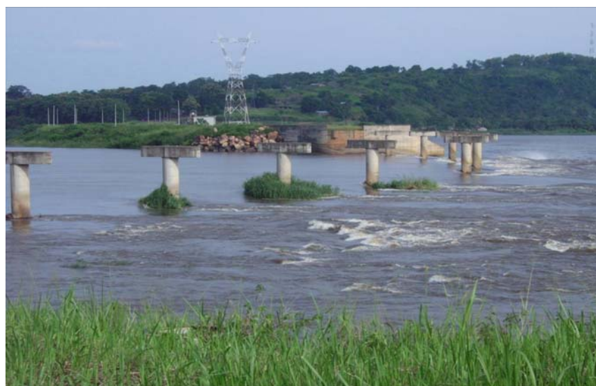
Photo A. Construction inachevée du barrage sur l'Oubangui à Mobaye, côté centrafricain (à gauche) alors que la production d'électricité se fait depuis 1989 sur le côté congolais (RDC à droite de la photo fournie par Séverin Gildas NGOCKO en 2011).
