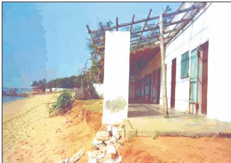
Fig. 7: situation de plage due à l'érosion côtière en novembre 2003 à l'hôtel Ramatou
